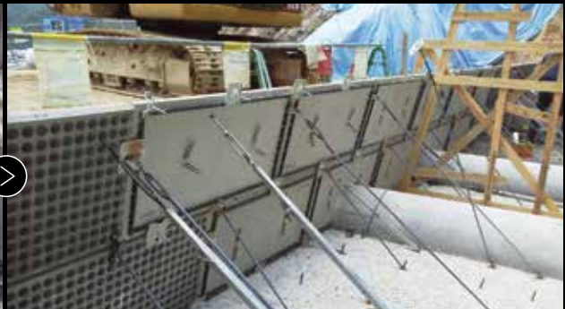
02: 専用勾配調整サポート使用状況
