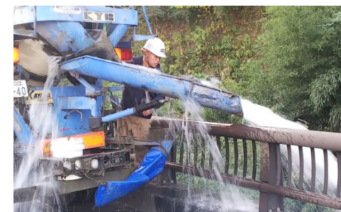
災害時における消防用水等の確保
