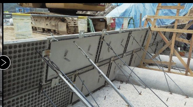
02: 専用勾配調整サポート使用状況
